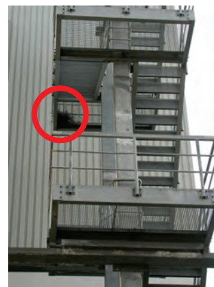
Abb. 12: Diese Feuertreppe am Bau 17 sollte wirklich nur in Notfällen betreten werden...
