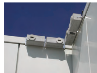
Abb. 14: Mauerseglerkästen am Bau 17
