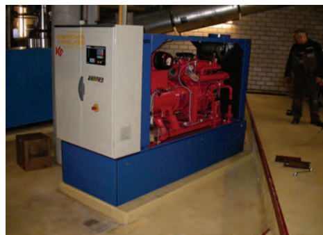
Abb. 38 und 39: Gymnasium Unterrieden - Blockheizkraftwerk
