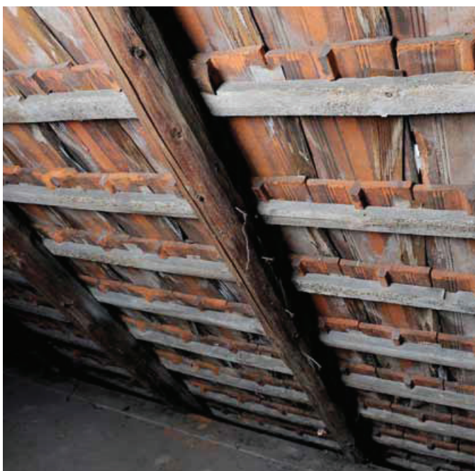
Oben alles dicht? Hier muss gedämmt werden.
